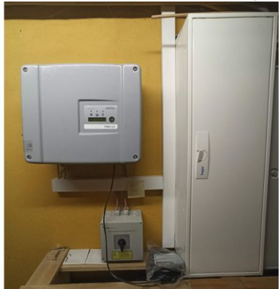
Wechselrichter, Trennschalter Zähler_Sicherungs_Schrank
